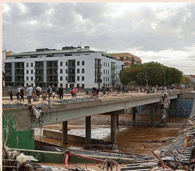
Imágenes de los daños de la dana a su paso por Paiporta en 2024.
